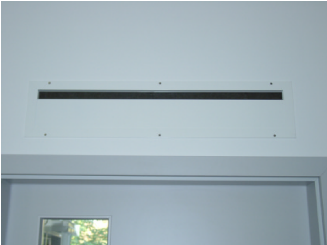
Abbildung 1: Schallgedämmte Überströmöffnung in Leichtbauwand oberhalb einer Tür
